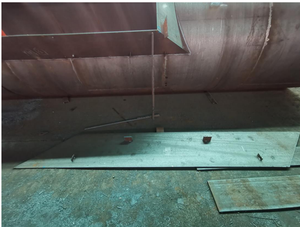
图六 肇事风口板（焊接吊耳的一面）
